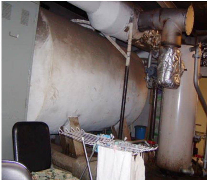
ボイラー本体を覆う石綿含有断熱材
