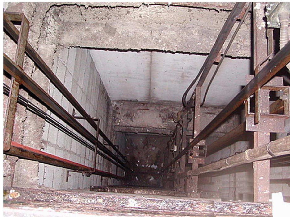
小荷物専用昇降機シャフト
