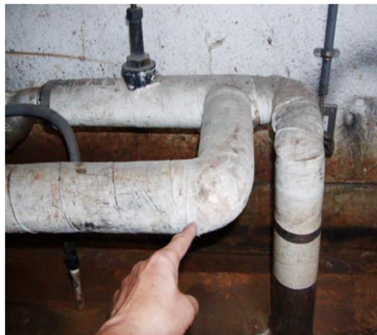
配管エルボを覆う石綿含有保温材
