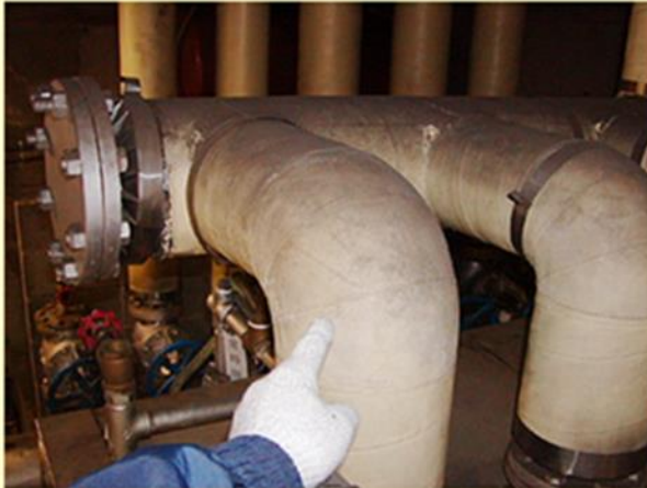
配管エルボ部分の石綿保温材 外観
