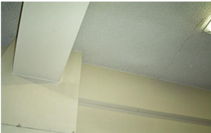
アスベスト含有吹付けひる石
