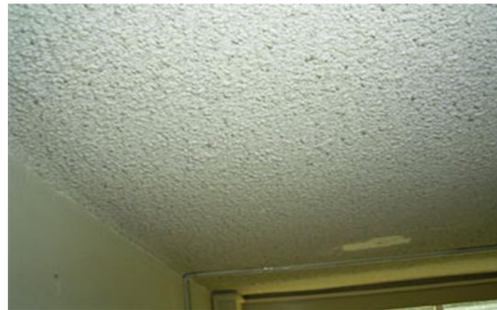
アスベスト含有パーライト吹付け
