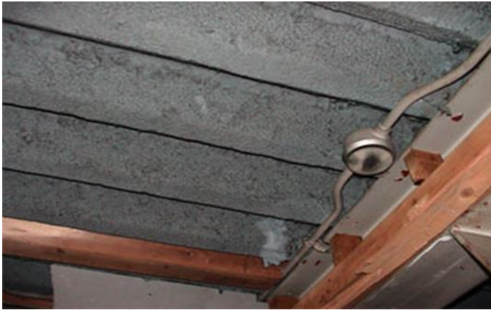
吹付けアスベスト
