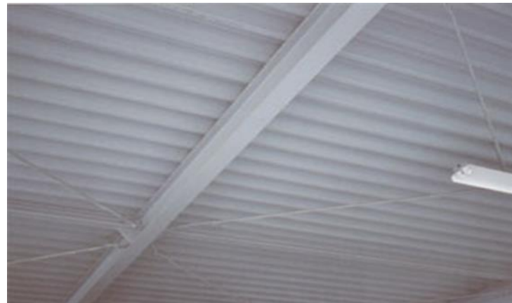
屋根用折版裏アスベスト断熱
