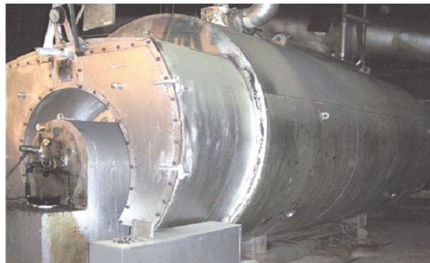
ボイラー保温材
