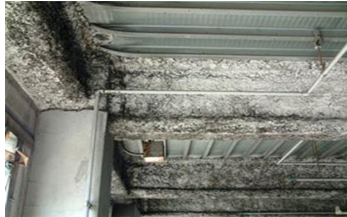
アスベスト含有吹付けロックウール
