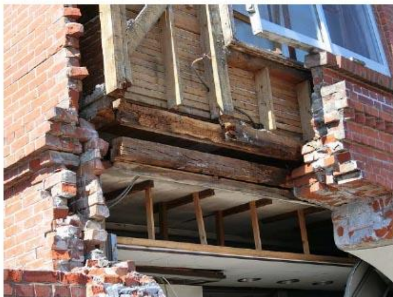
写真 5.3.13 写真 5.3.11 の露出した躯体の腐朽・蟻害
