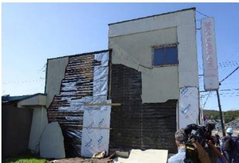
写真 5.3.21 外装材の脱落した建築物
