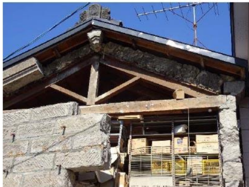
写真 5.3.18 写真 5.3.17 の小屋組
