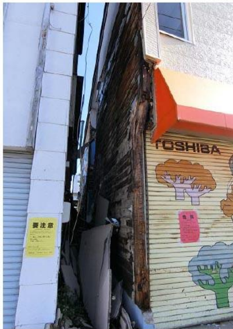
写真 5.3.27 写真 5.3.25 の外壁の激しい腐朽と残留変形
