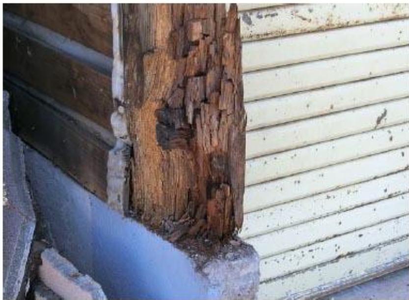
写真 5.3.26 写真 5.3.25 の柱脚の激しい腐朽
