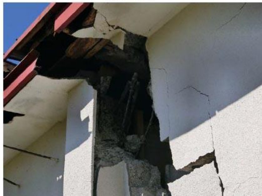
(d) 破壊部分の詳細 (頂部)
