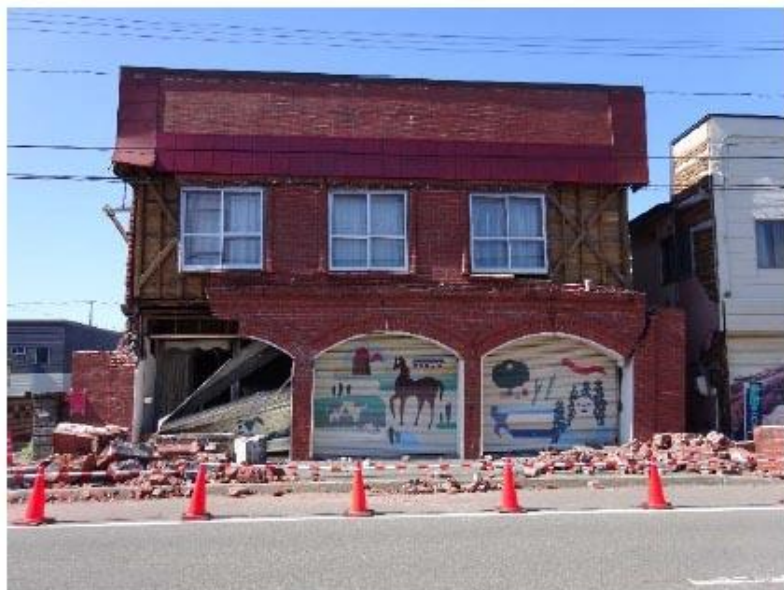
写真 5.3.11 外壁煉瓦の木造建築物の被害
