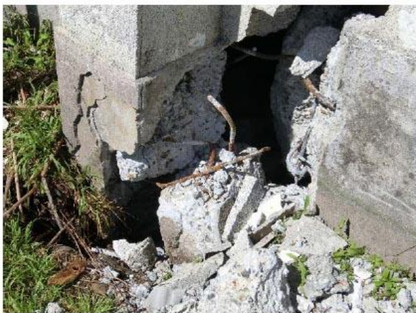
(c) 破壊部分の詳細 (底部)
