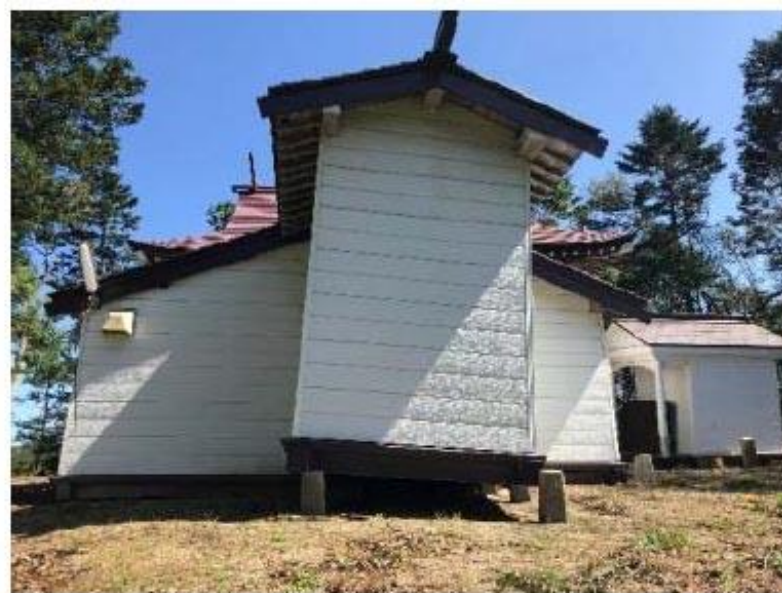
写真 5.2.12 寺社建築 C 西側の破壊状況
