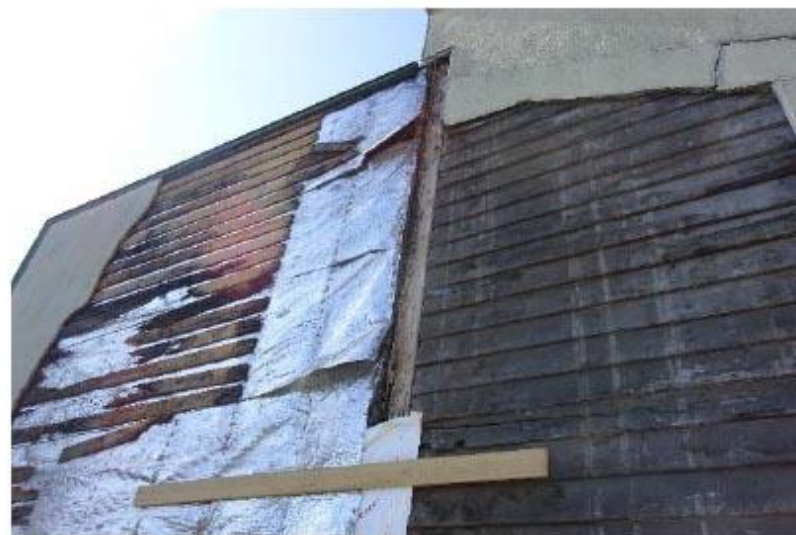
写真 5.3.22 写真 5.3.21 の壁面(柱・壁の腐朽)
