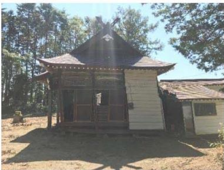
写真 5.2.11 寺社建築 C 北側の破壊状況
