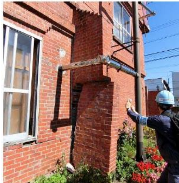
写真 5.3.14 写真 5.3.11 の破損した控え壁のような部分
