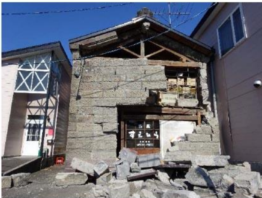
写真 5.3.17 比較的古い組積造の壁の崩落
