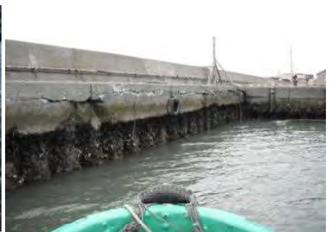
【老朽化が著しく対策が必要な漁港施設】
