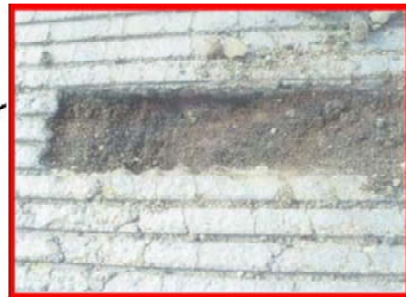
・ 舗装にクラック、砂利状化、表面劣化、表面膨れ
