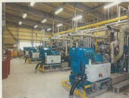
バイオマス発電機
