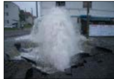
上水道配水管の漏水
