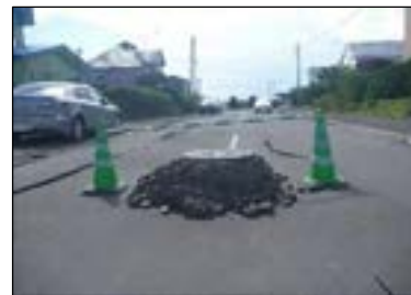
マンホールの突出 (2018.9 安平町)
