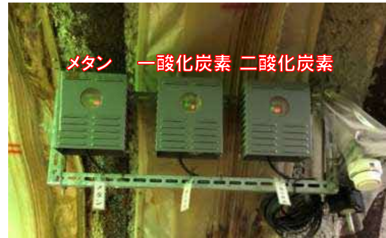
地下の環境を監視するセンサー
